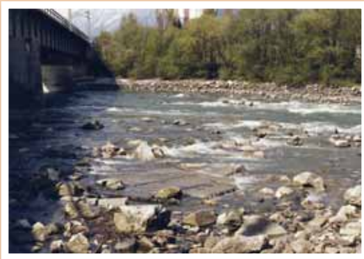
Bei Niedrigwasser sind heute noch die gigantischen Pfeilerfundamente der alten Eisenbahnbrücke zu sehen.
