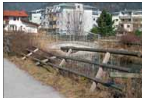
Eingetretene Zäune beim Wohn- u. Pflegeheim.
