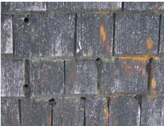
Enorme Schäden am Dach der Kirche machten eine umgehende Sanierung erforderlich.
