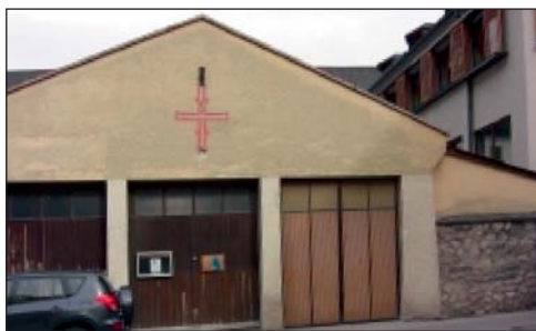
Das alte Feuerwehrmagazin – städtebaulich kein Schmuckstück. Ein Abriss schafft Platz für die dringend erforderlichen Räume.
